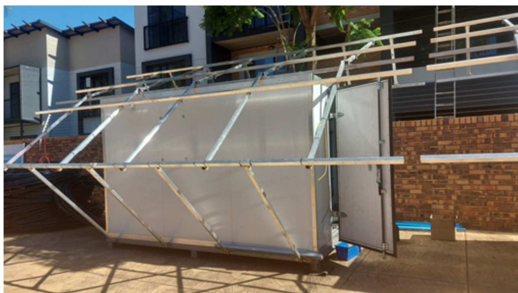
Photo 25. Bloc de potabilisation de l'eau fonctionnant à l'énergie solaire/ South-Africa
