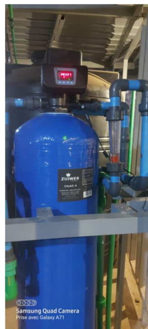
Photo 12. filtre à sable
