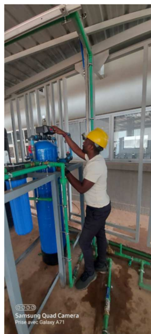
Photo 11. paramétrage d'un filtre à sable
