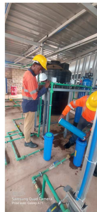
Photo 13. fixation d'un filtre KDF
